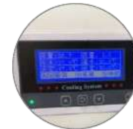
Enfriador de agua industrial
